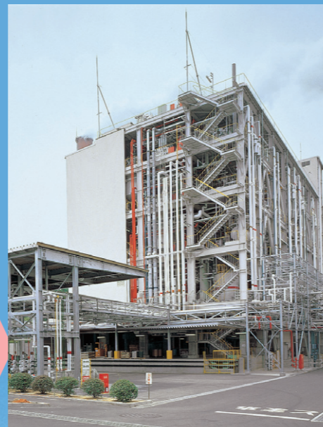
和歌山工場(プラントの一部)
