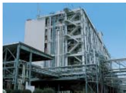
化学製品の反応・製造設備
