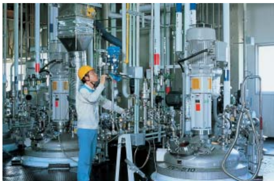
化学製品の配合設備
