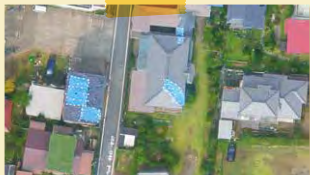
多発した屋根被害（千葉県君津市）
